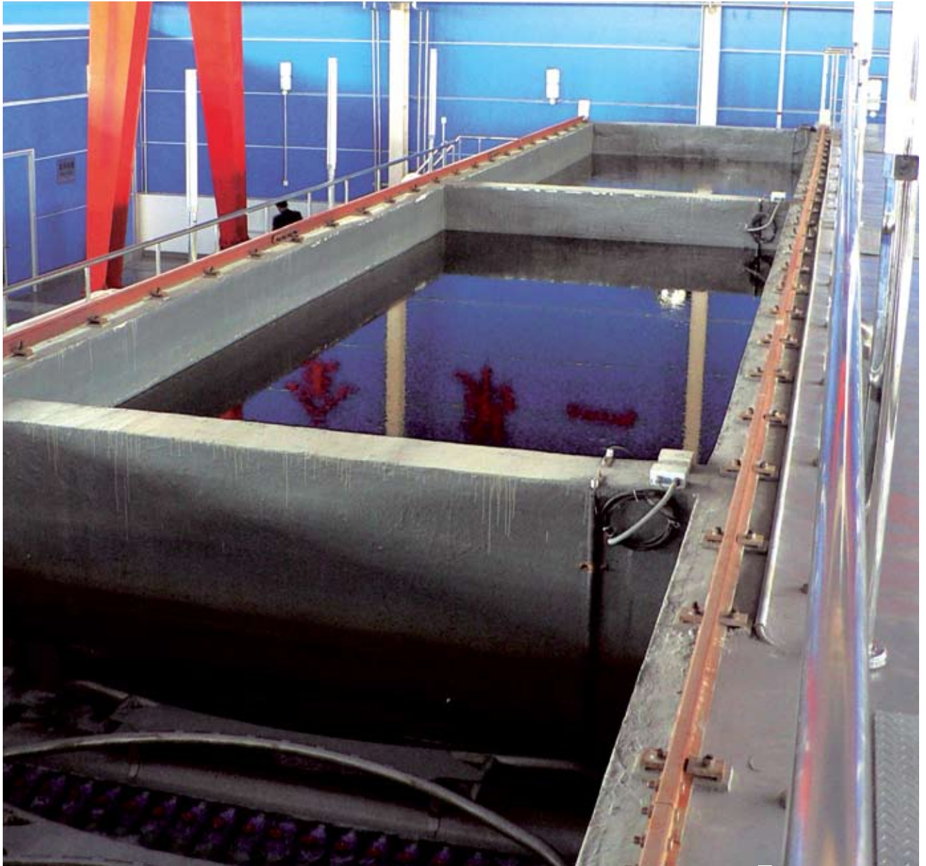
Traitement des eaux usées à la station d'épuration de Qinghe.
